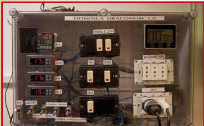
Quadro di comando
